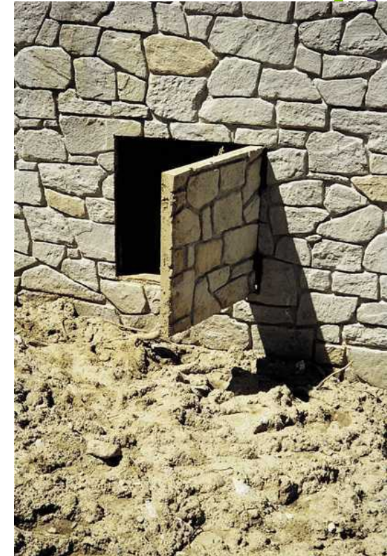
Trappe de visite
